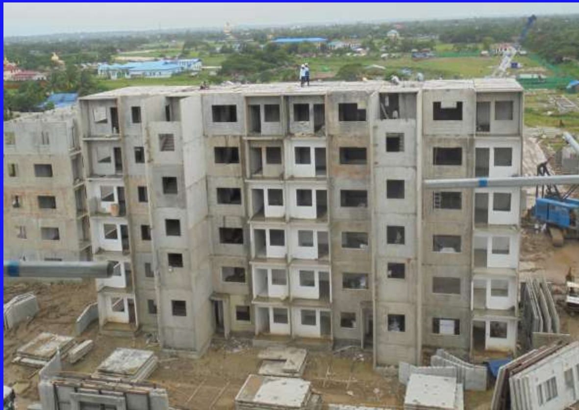
Building B-2 လုပ်ငန်းပြီးစီးပုံ မြင်ကွင်း။
