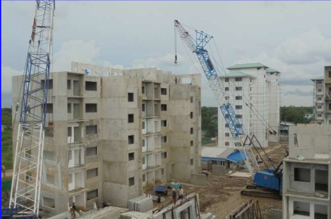
Building A-2 7 th FL Wall Installation လုပ်ငန်းဆောင်ရွက်နေပုံ ။
